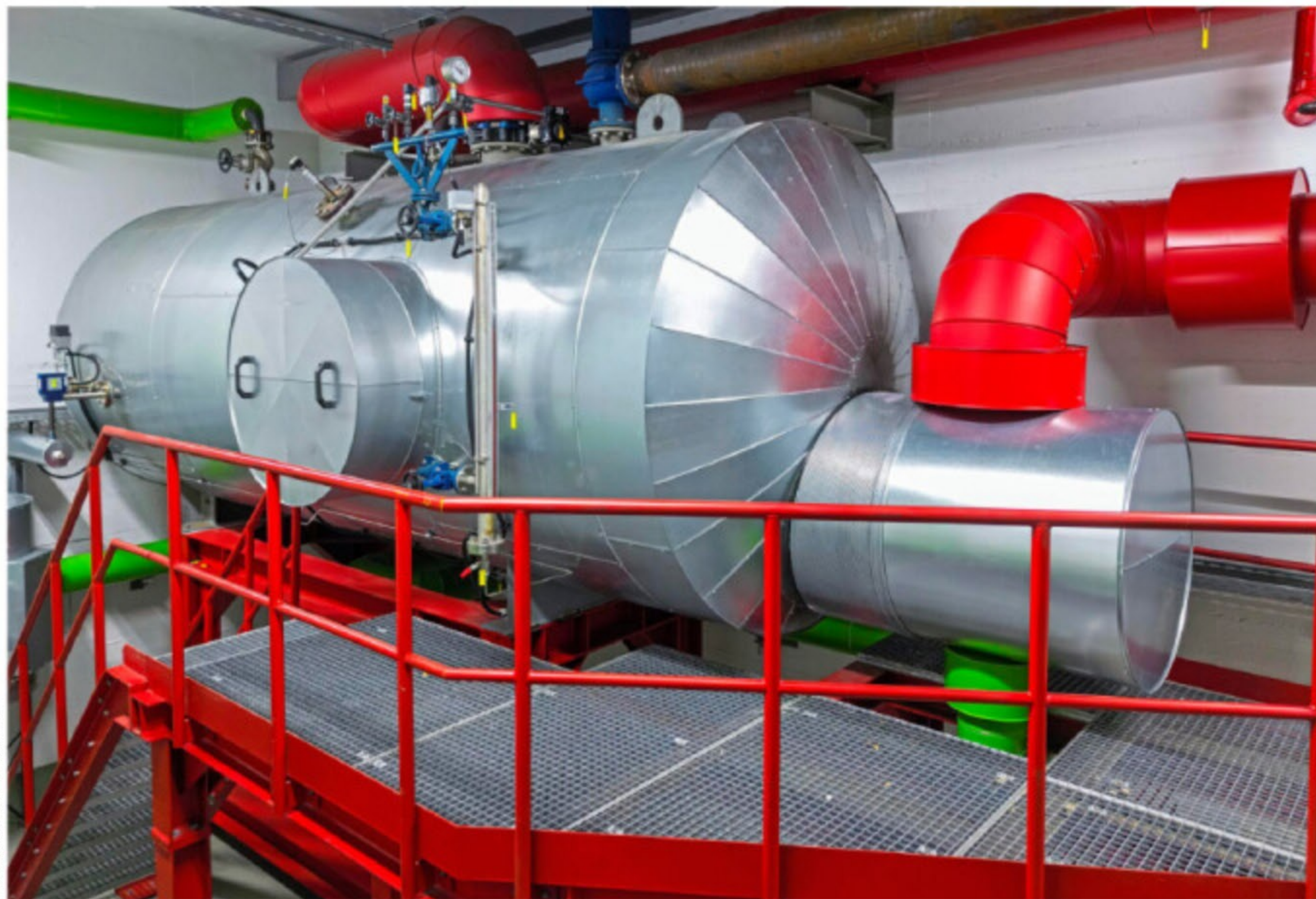
Heiße Luft: Über diesen Wärmetauscher versorgt das Stahlwerk von Thyssenkrupp Steel in Duisburg den Nachbarn König-Brauerei mit Energie aus Abwärme.
